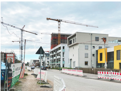
6.18 Bauprodukte, die in Gebäude eingesetzt werden, müssen in Deutschland zugelassen werden
