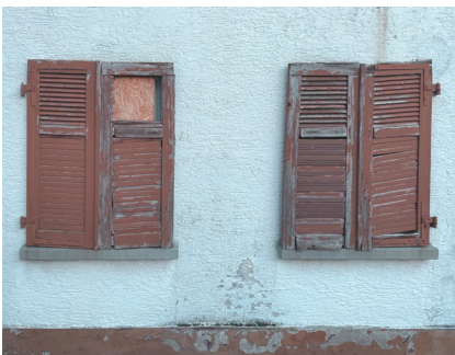
6.19 Beschädigte Baumaterialien sind nicht marktfähig
