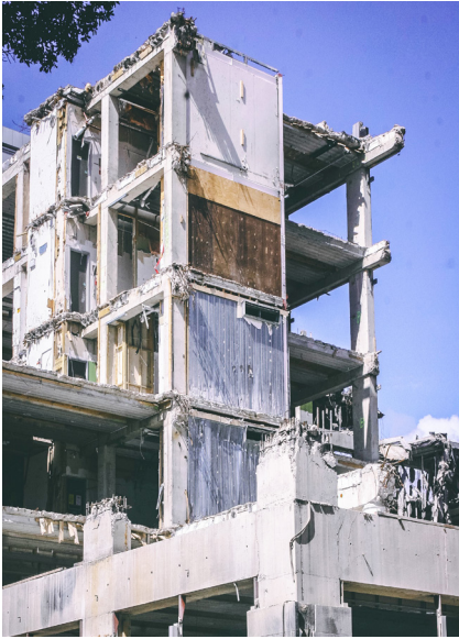
6.13 In einer funktionierenden Kreislaufwirtschaft muss der eventuelle Rückbau von Gebäuden mitgedacht werden.
