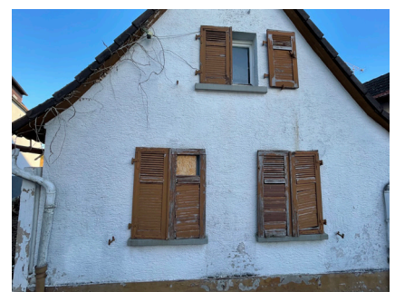
5.37 Verfallende Bausubstanz im Ortskern von Münster
